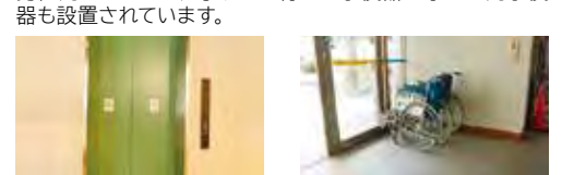
エレベーター
